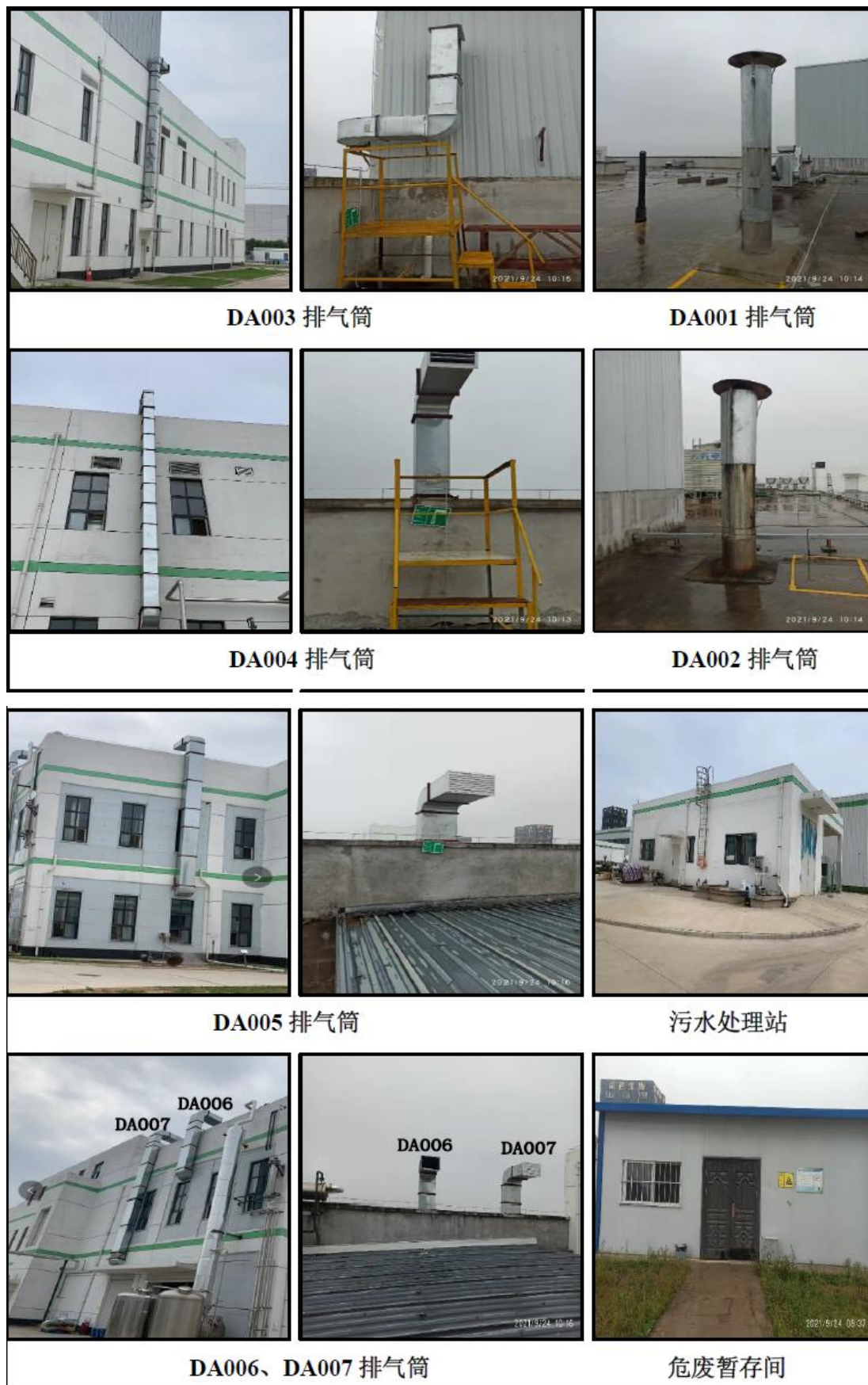
图 2.8-1 现有工程环保设施照片
