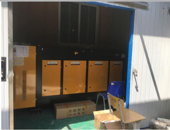
现有注塑车间废气治理措施
