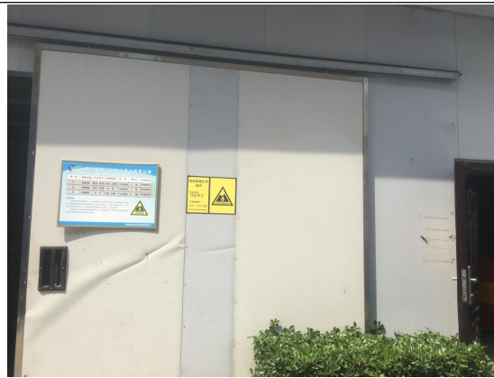
现有危废暂存间
