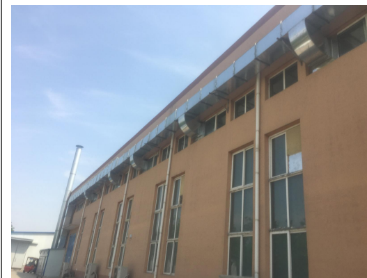
注塑车间集气管道及排气筒
