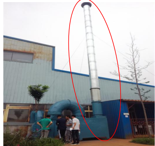
磨床粉尘处理后排气筒
