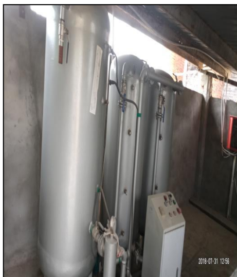
隔油处理设施
