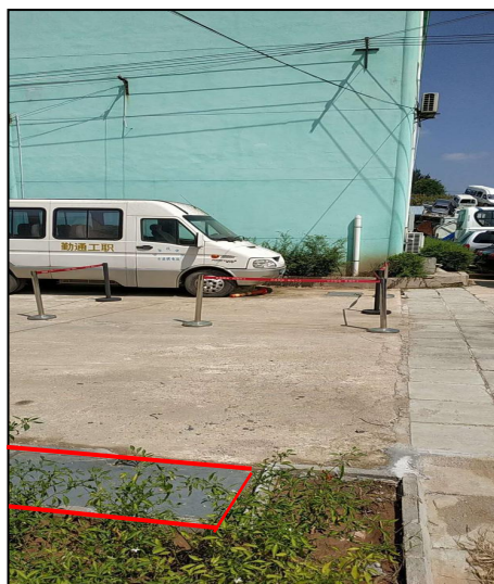
办公楼化粪池
