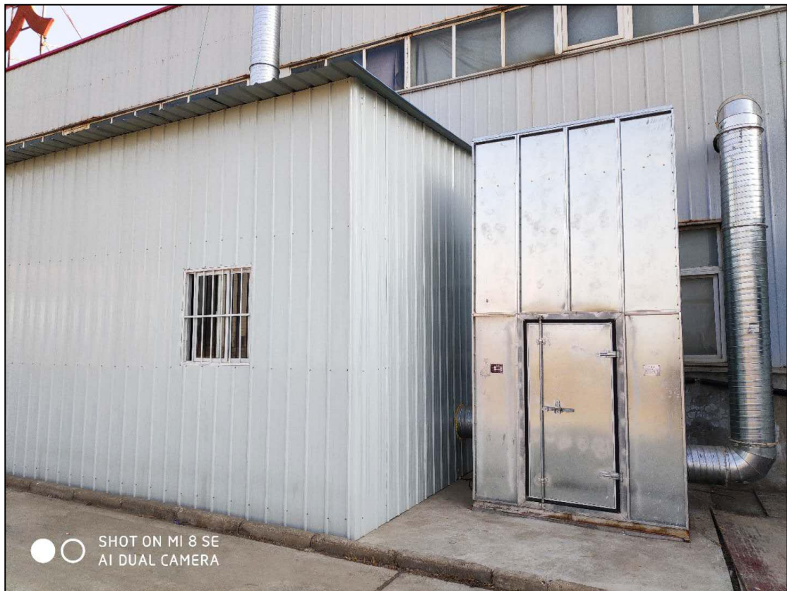
1#有机废气净化设备
