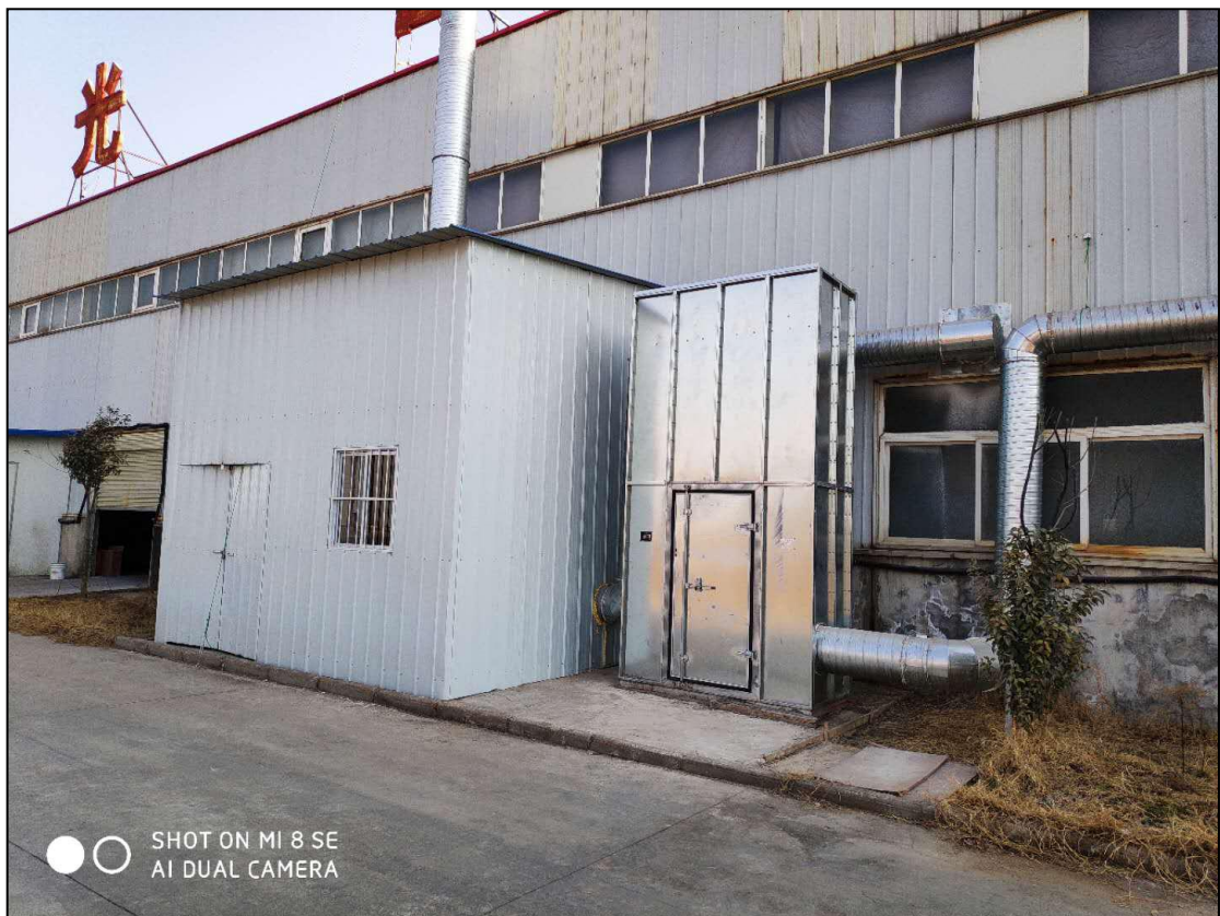
2#有机废气净化设备
